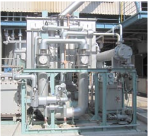
VOC回収装置(姫路工場)
