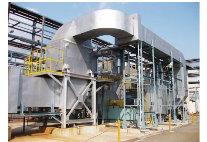
都市ガス仕様の低NO x ボイラー(別府工場)
