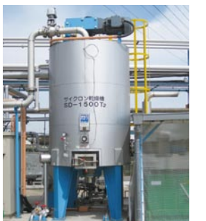
汚泥乾燥設備(姫路工場)
