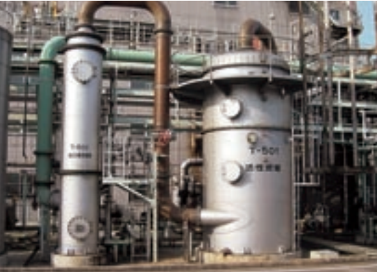
排ガス除害設備
