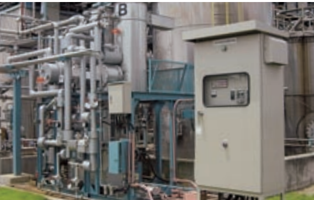
ガス回収装置（姫路工場）
