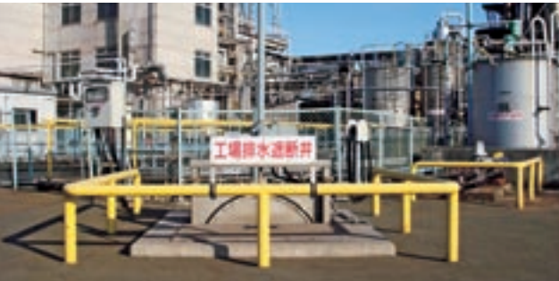
排水浄化設備（別府工場）
