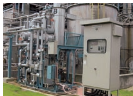
ガス回収装置（姫路工場）
