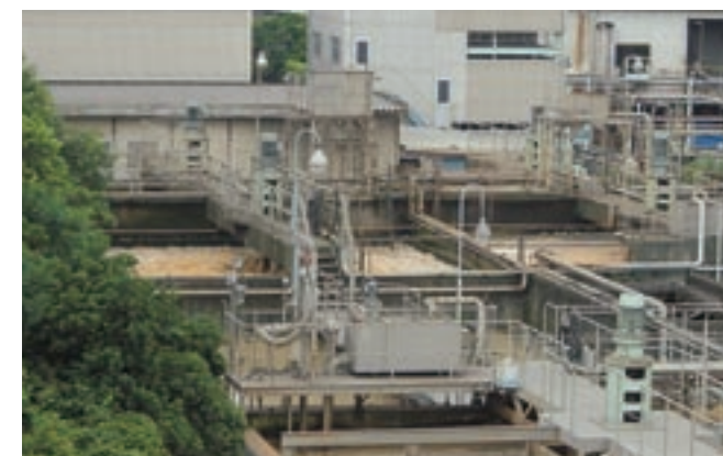
排水浄化設備（姫路工場）
