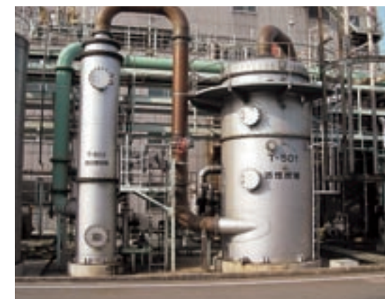
排ガス除害設備
