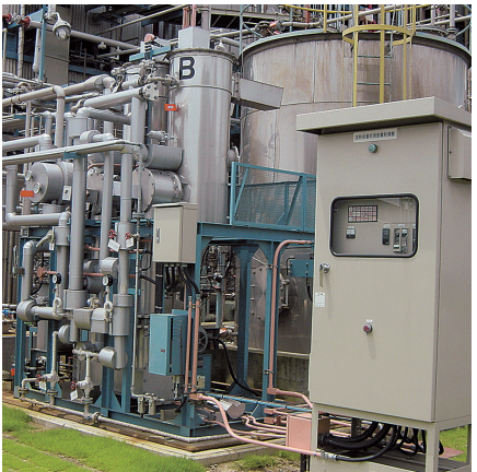
ガス回収装置(姫路工場)
