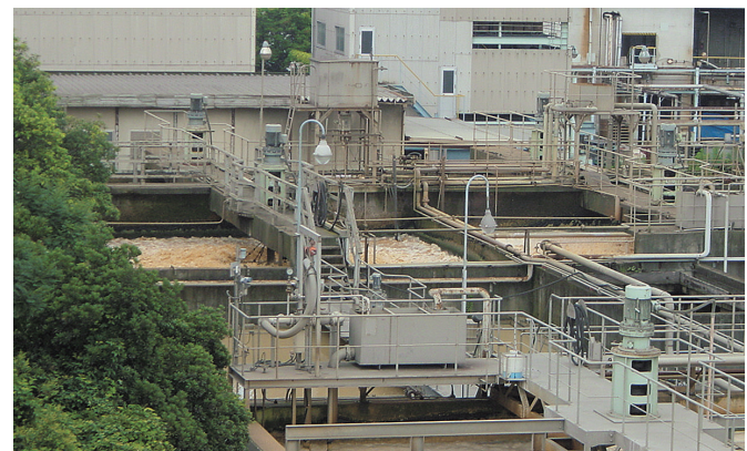
排水浄化設備（姫路工場）
