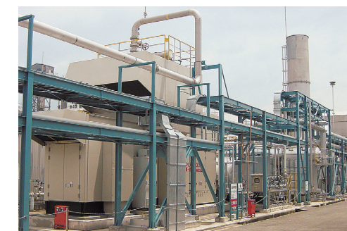
コージェネレーションシステムの導入(姫路工場)
