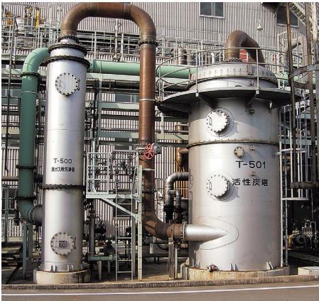
排ガス除害設備
