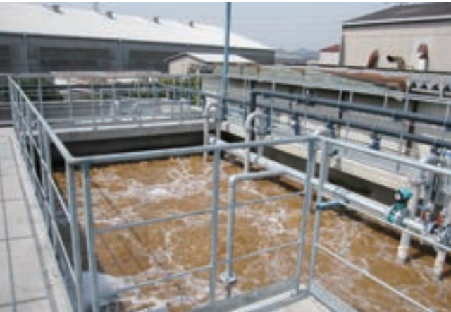
排水処理設備
